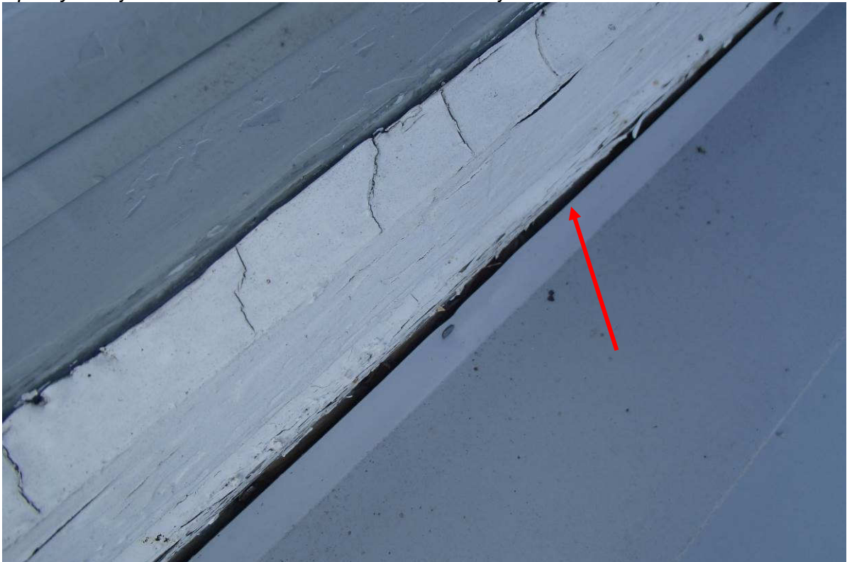
Kuva 25. Vesipellityksen ja ikkunarakenteen välissä havaittiin rakoja rakenteiden sisään.
