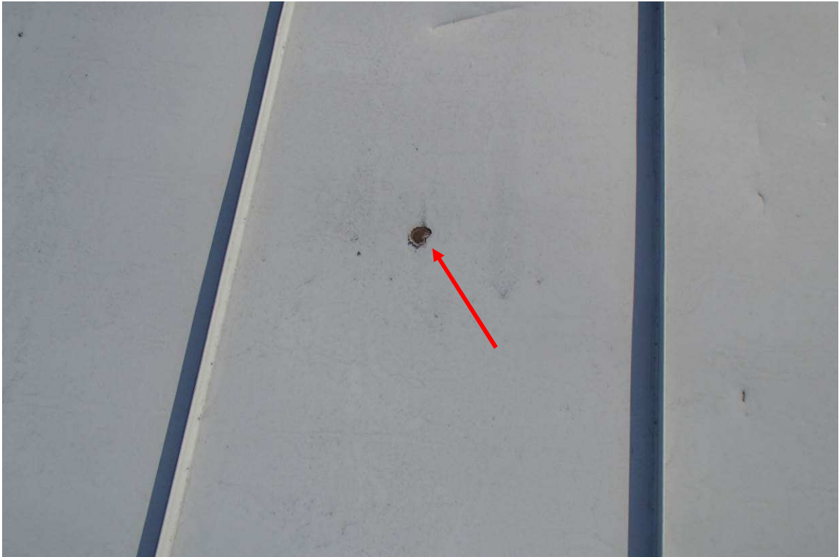
Kuva 40. Vesikatteen pinnoitteessa havaittiin irtoilua.
