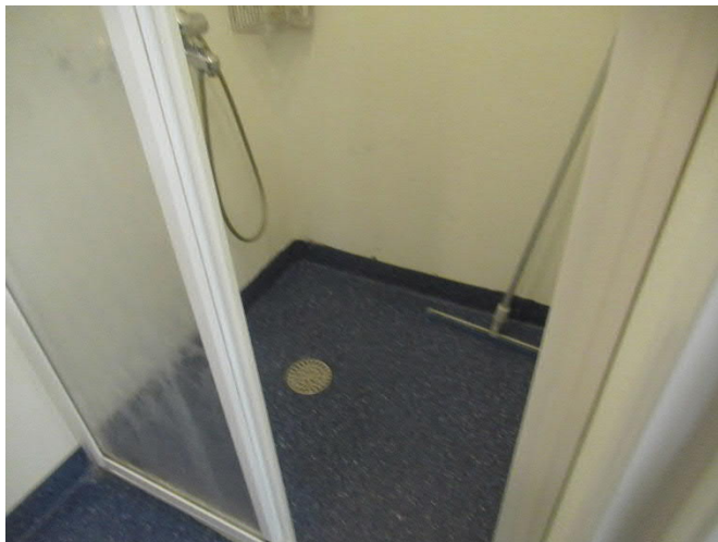
Kuva 3.6.2: Väestönsuojassa olevien märkätilojen seinä- ja lattiapinnat ehdotetaan uusittavan vedeneristeineen.
