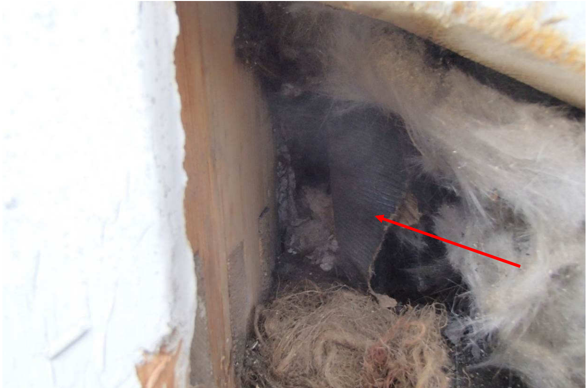
Kuva 22. Luokkien välisen eristeen taustalla havaittiin tervapaperi.
