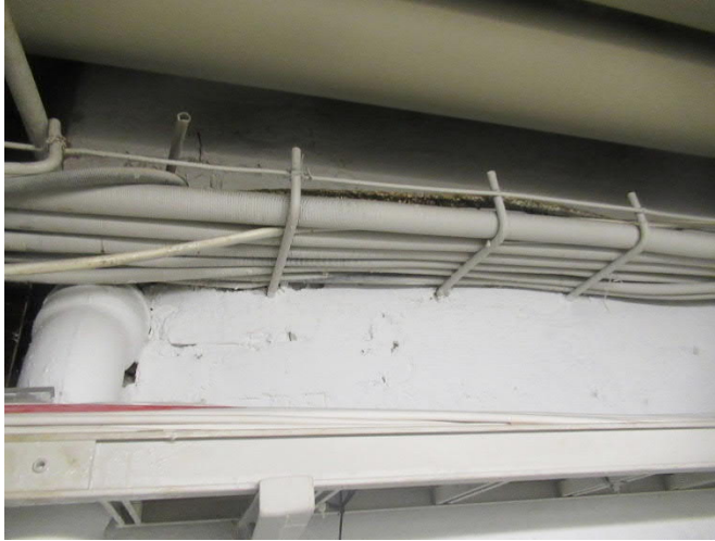
Kuva 4.2.1: Vanha muovillinen valurautaviemäri pohjakerroksen käytävätilan katossa.
