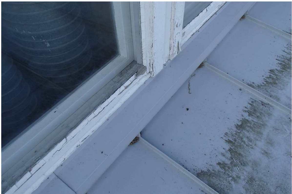
Kuva 23. Yläikkunoiden maalipinnat ovat ikääntyneet ja irtoilleet.
