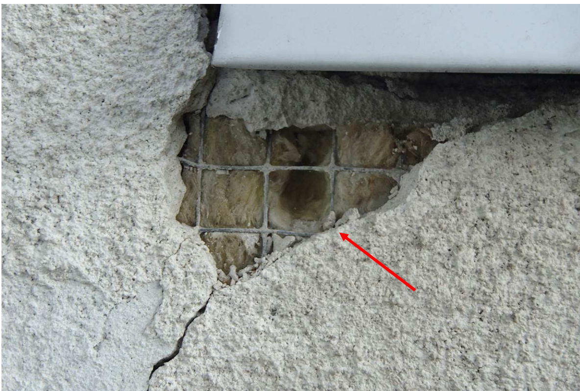
Kuva 29. Paikoin vaurioalueen lämpörappauksen rappauslaastit ovat irtoilleet.
