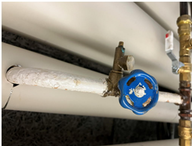
Kuva 4.1.1: Vanha lämmitysverkoston sulkuventtiili.
