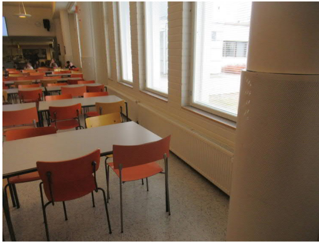
Kuva 3.6.1: Lattianrajojen sekä lattioiden ja seinien liittymien tiivistyksien arvioidaan ajoittuvan tarkastelujaksolle.
