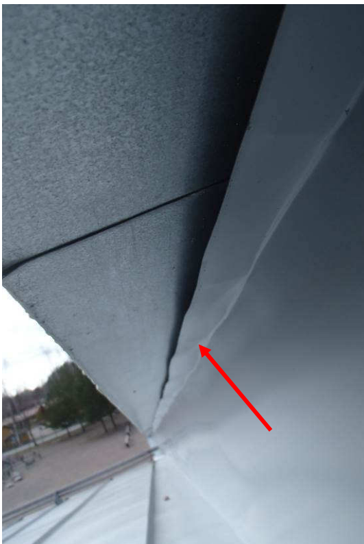
Kuva 49. Vesikaton vastataitokset ovat paikoin puutteellisia.
