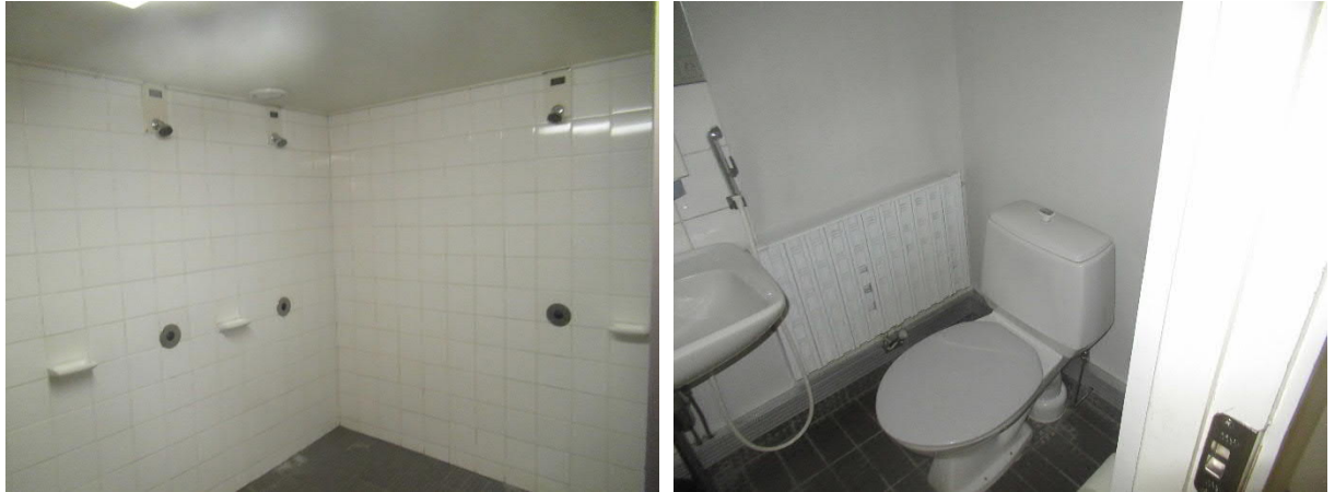
Kuva 3.6.1: Ikääntyneet pukuhuone- ja märkätilat, joiden pintamateriaalit vesieristyksineen on syytä uusia.
