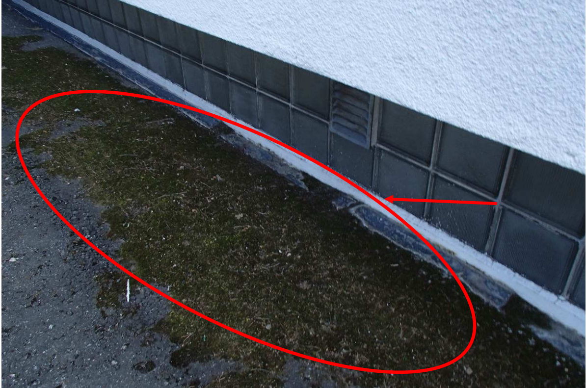
Kuva 34. Sokkelin yläpinta on paikoin samassa korkopinnassa piha-alueen kanssa ja rajapinnoilla kasvaa sammalta.
