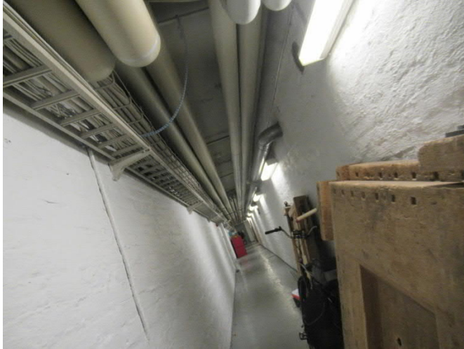
Kuva 3.3.3: Putkitunnelin vanhoja maalipintoja. Kohde on aikakaudelta, jolloin pintarakenteissa ja maaleissa on käytetty asbestia sekä muita nykyään haitta-aineiksi luettavia aineita.
