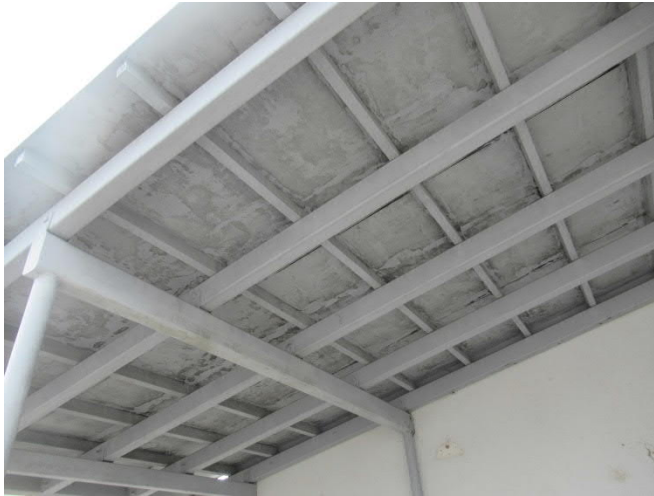
Kuva 3.4.5: Tarkastelujaksolla on perusteltua varautua katosten runko-osien ja levyverhousten puhdistuksiin ja pintakäsittelyihin.
