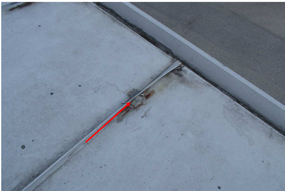
Kuva 43. Konesaumapeltikatteessa havaittiin paikattuja reikiä.
