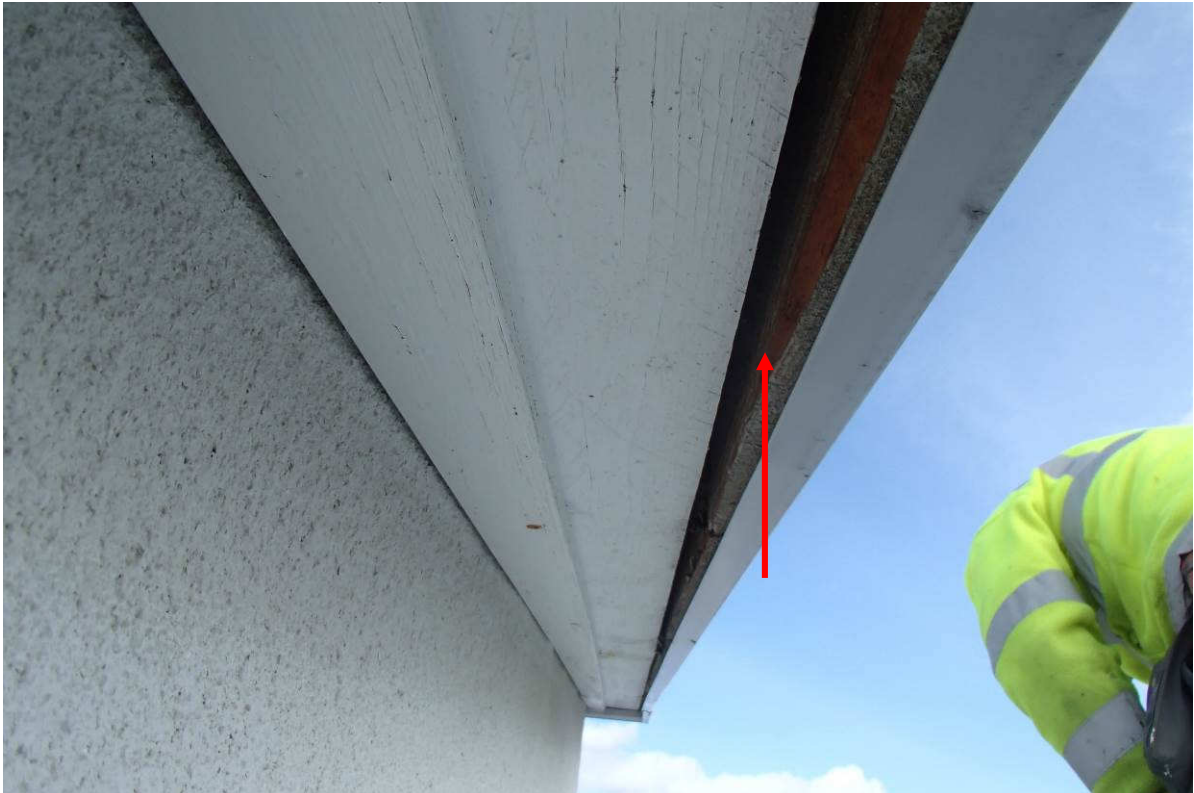
Kuva 48. Räystäiden alapuolella ei havaittu hyönteisverkkoja.
