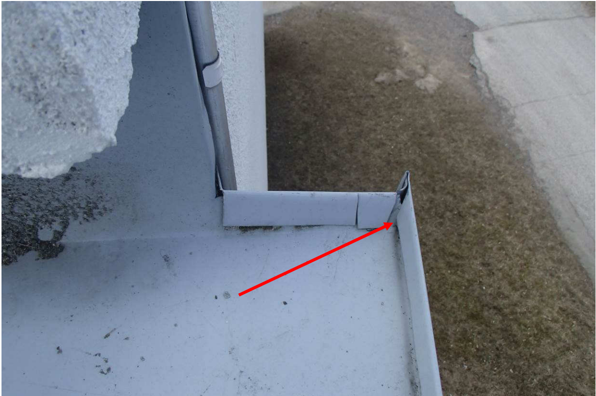
Kuva 52. Paikoin otsapellityksen liitokset eivät ole asianmukaiset.
