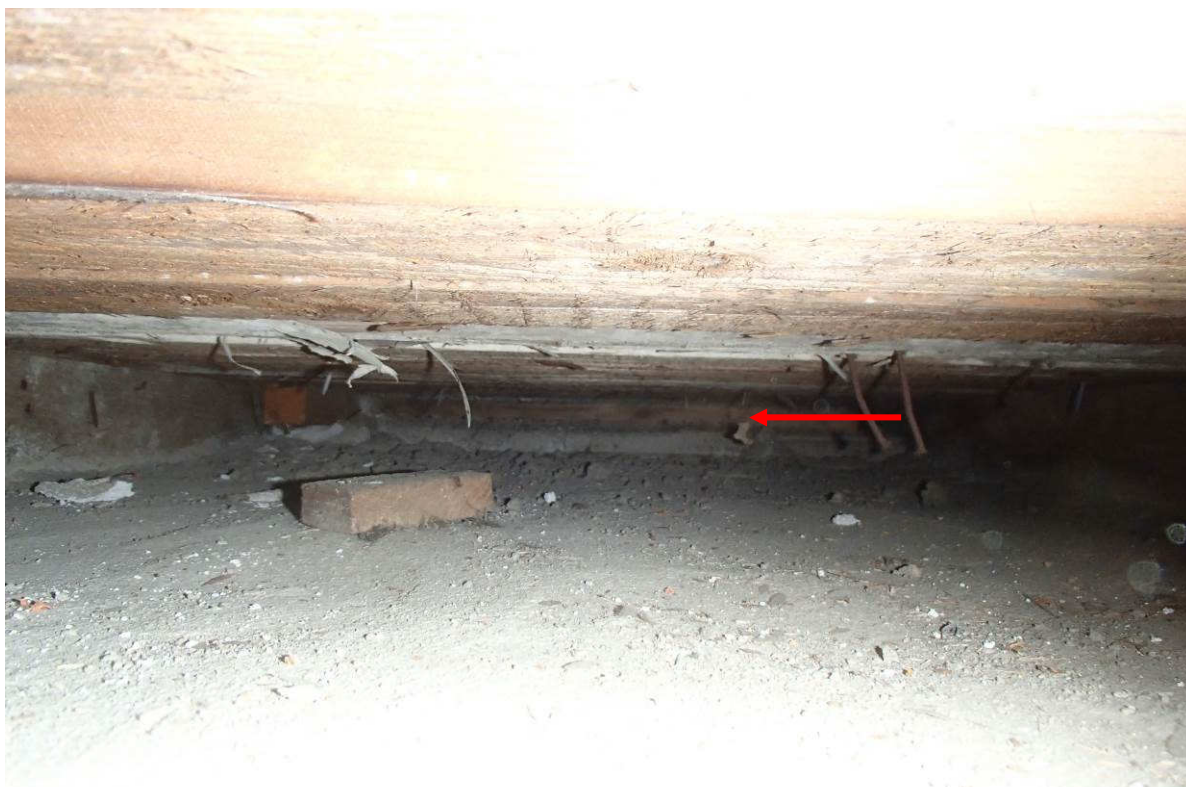
Kuva 57. Tuulettuvassa tilassa havaittiin kattovasojen välissä rakennuksen pitkittäissuuntaisesti puumateriaalia, joka estää osittain yläpohjan tuulettumisen.
